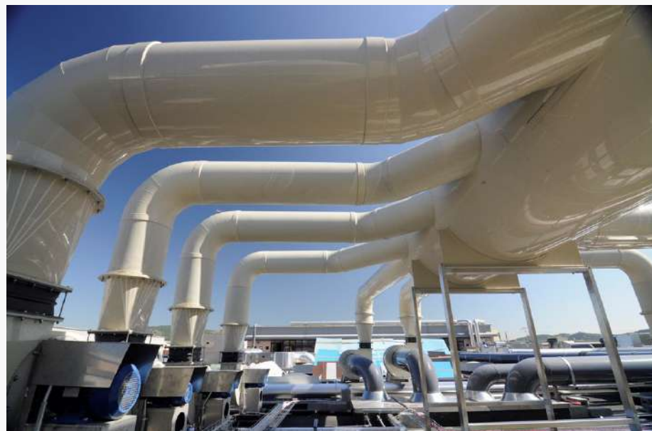
Impianto di depurazione - Pratella
